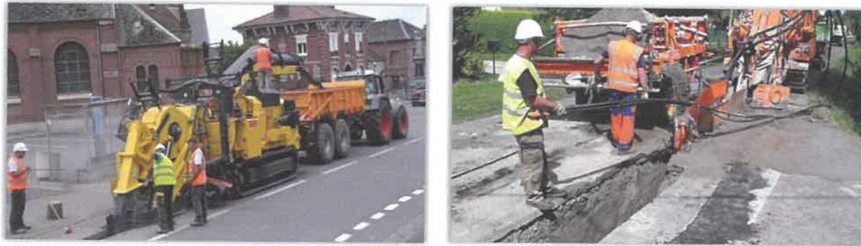
Figure 225 : Illustration d'un passage de câbles électriques sous voirie (Source : La Voix du Nord, Ouest France)
